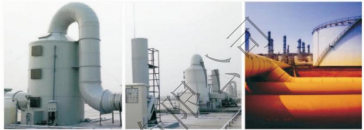
循环水等大管道液体
