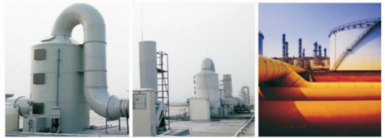
循环水等大管道液体
